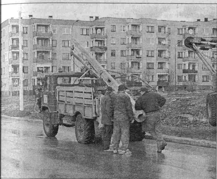
Na osiedlu Pod Dalią będzie teraz więcej latarni, a zatem nieco bezpieczniej
